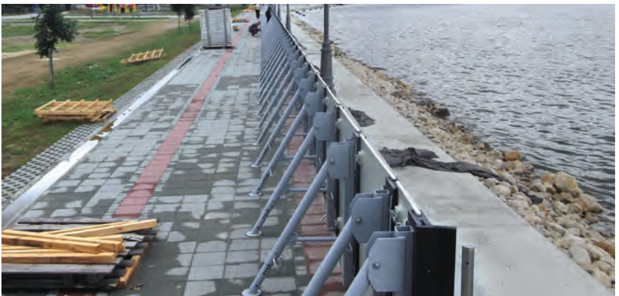
Hochwasserschutz mit Hochwasserschutzplatten aus Kunststoff
